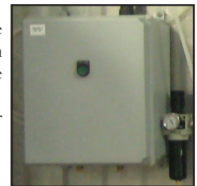
Door control box
