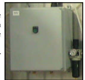
Door control box
